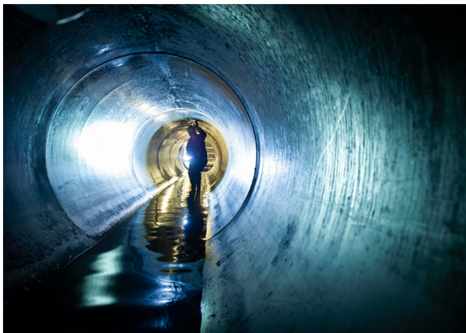
Ein gut 400 Meter langer Kanal fungiert unter der Stubenrauchstraße als Regenwassertank.
