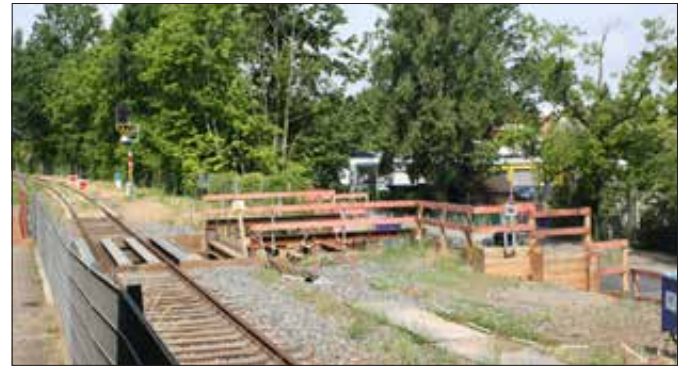
Der neue Zugang zu den Bahnsteigen zum S-Bahnhof Alt-Reinickendorf lässt auf sich warten. Foto: Karla Veecken
