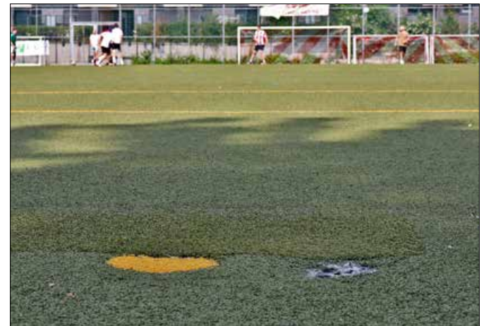
Die Schäden im 2007 verlegten Kunstrasen sind unübersehbar. Foto: as
