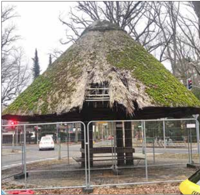
Beschädigt und eingezäunt: Wetterpilz in Frohnau an der B96 Foto: viv
