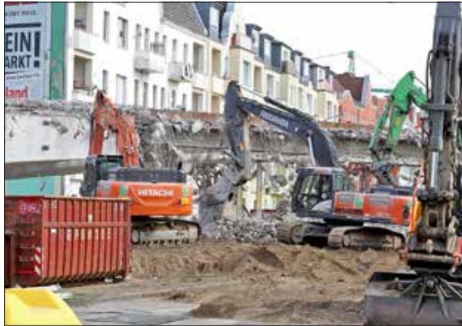
Am Samstag, 18. März, um die Mittagszeit waren die Abrissarbeiten schon weit fortgeschritten. Fotos (2): bek
