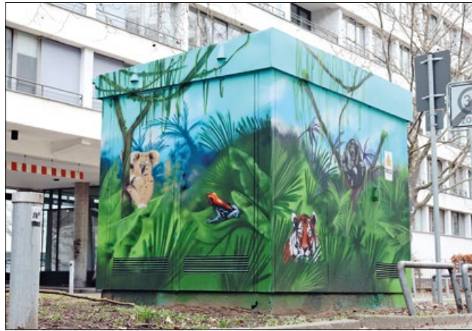
Das gestaltete Trafohäuschen in der Triftstraße
