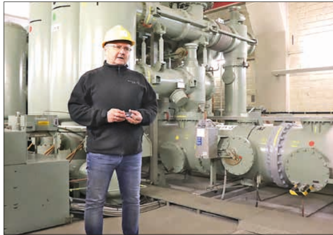
Netzbezirksleiter Uwe Kairys vor dem alten Netzknoten
