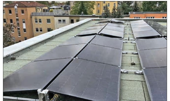
Anlage auf der Hausotter-Grundschule
