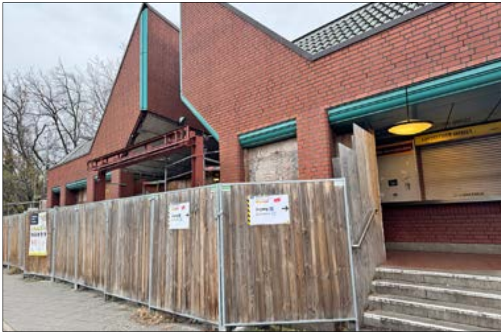
Eingang U8 Rathaus Reinickendorf: Der Zugang ist offen, aber die Sanierung des Eingangsgebäudes beginnt erst jetzt. Fotos (2): fle
