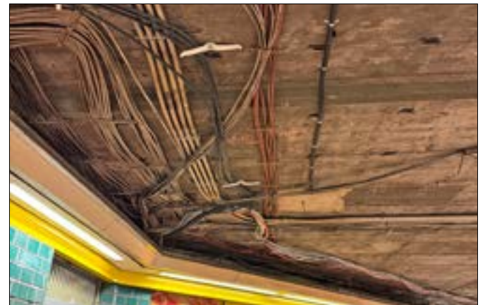
Kabelsalat: Der Eingang zur U-Bahn vom Franz-Neumann-Platz ist zwar offen, aber an der Decke hängen die Kabel alle offen. Das Verkleiden der Decke soll erst 2027 beginnen.
