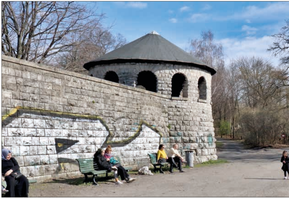
Die Hoffnung auf eine Sanierung der Bastion im Schillerpark ist groß.
