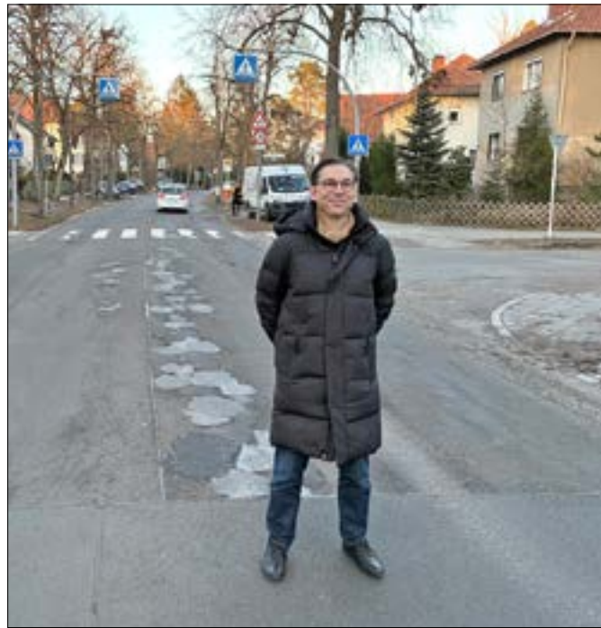
Ulf Wilhelm auf der Zeltinger an der Nahtstelle zwischen instandgesetzter Asphaltdecke und Schlaglöchern.
