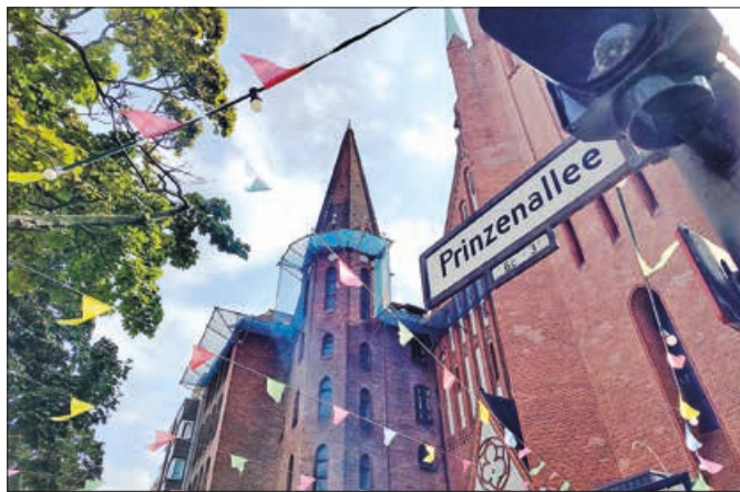
Netze hängen schon lange an der Stephanuskirche. Sie sollen verhindern, dass Teile herabfallen. Foto: dh
