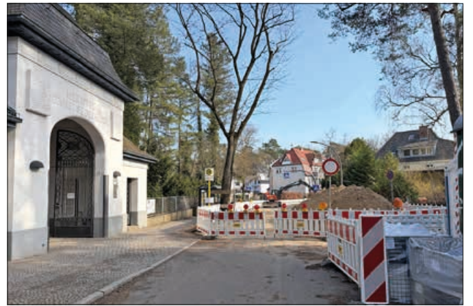
Die Baustelle zwischen Friedhof und Falkentaler Steig war am Osterwochenende kurz offen. Foto: fle
